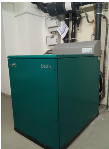
Foto: BHKW der FEST
