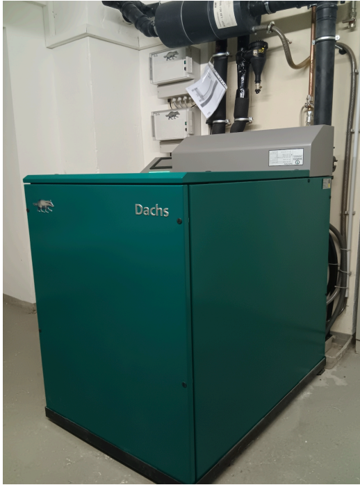
Foto: BHKW der FEST
